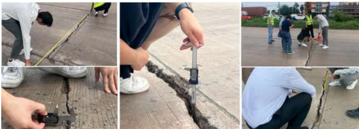
รูปที่ 1-164 รายละเอียดความเสียหายผิวทางคอนกรีต แปลงทดสอบที่ 1.2 : ผิวคอนกรีต จุดที่ 2 สายทาง 304-401 ช่วงกม. 141+500 เลน R2
