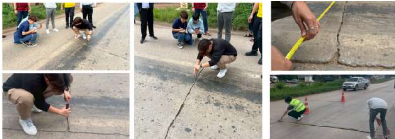
รูปที่ 1-163 รายละเอียดความเสียหายผิวทางคอนกรีต แปลงทดสอบที่ 1.1 : ผิวคอนกรีต จุดที่ 1 สายทาง 304-401 ช่วงกม. 142+025 เลน R2
