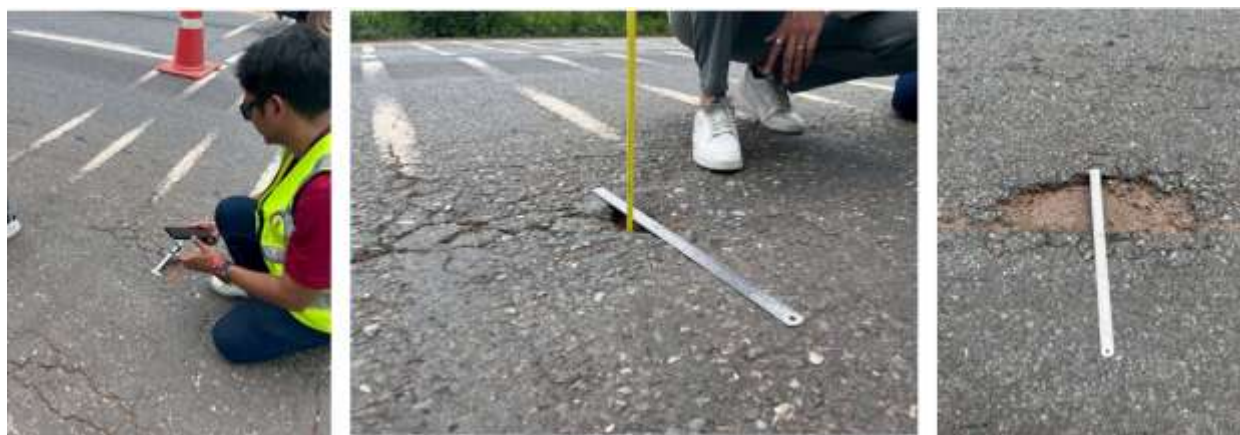
รูปที่ 1-165 รายละเอียดความเสียหายผิวลาดยาง แปลงทดสอบที่ 2.1 : จุดที่ 1 สายทาง 304-401 ช่วงกม. 145+375 เลน R2
