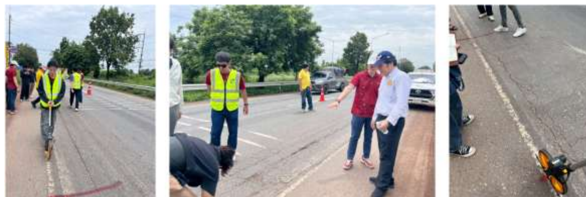
รูปที่ 1-167 รายละเอียดความเสียหายผิวลาดยาง แปลงทดสอบที่ 2.3 : จุดที่ 3 สายทาง 304-401 ช่วงกม. 145+375 เลน R2
